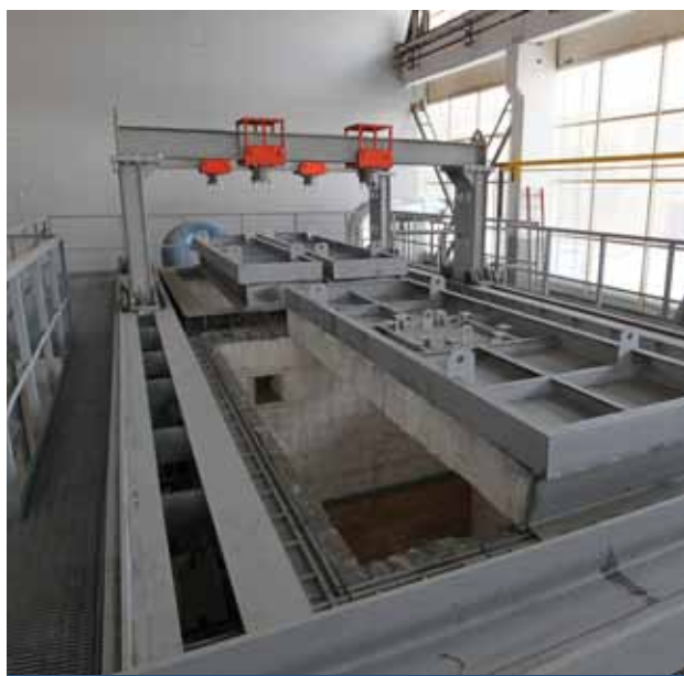
Испытательный стенд «Горизонтальная огневая печь»
