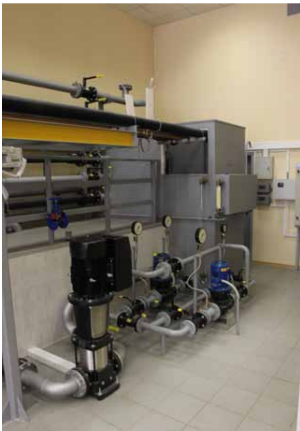
Лабораторная насосная установка GRUNDFOS
