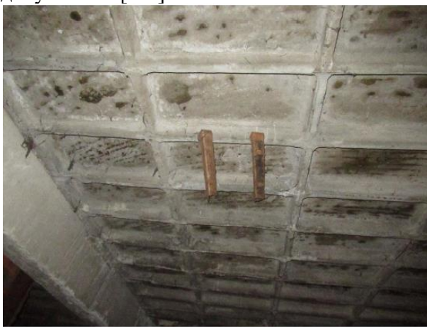
Рис. 2. Следы протечек с кровли
