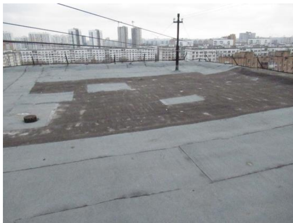
Рис. 3. Наличие вздутий и складок на поверхности кровли. Мелкая сетка трещин на поверхности рулонного гидроизоляционного ковра. Следы застоя воды.
