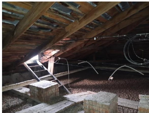
Рис. 2. Повреждение гнилью обрешетки кровли
