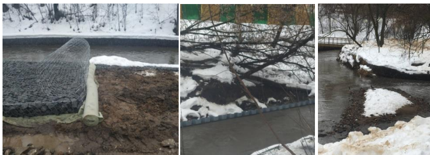
Рисунок 5. Берегоукрепительные сооружения и нанос в русле р. Лихоборки
