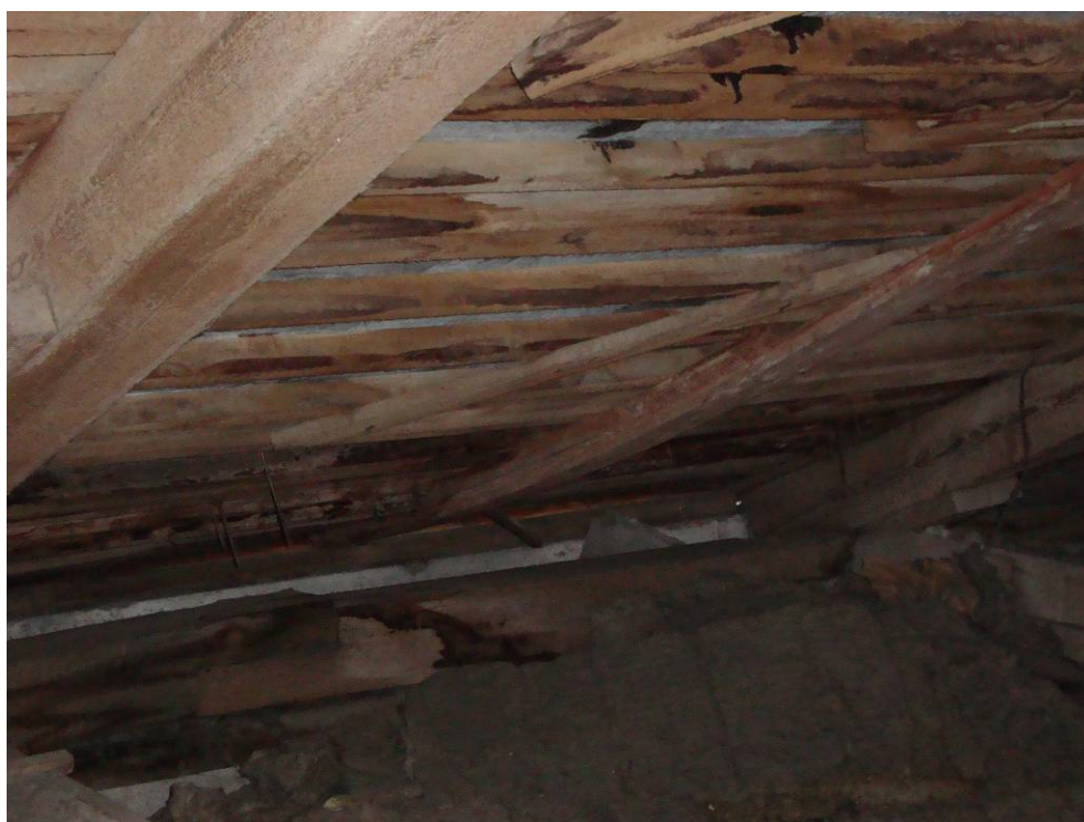
Рисунок 21 - Узел опирания стропил на стену через брус мауэрлат. Отмечено намокание деревянных конструкций покрытия из-за неудовлетворительного состояния кровли
