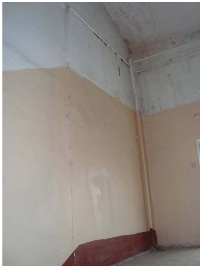
Рисунок 33 - Характерная трещина в стене по оси 2/В-Ж в уровне 5-го этажа - чердака по швам кладки из блоков из-за неравномерных осадок фундаментов. Намокание кладки стен.
