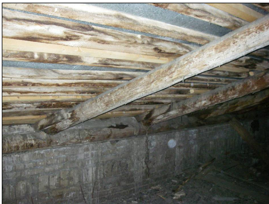
Рисунок 11 - узел опирания стропил на стену через брус мауэрлат ( \varnothing 18\text{см} ). Отмечено намокание деревянных конструкций покрытия из-за неудовлетворительного состояния кровли
