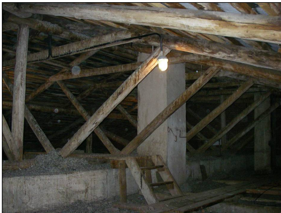
Рисунок 10 - общий вид покрытия в правом крыле здания. Стропила выполнены из бревна \varnothing 16\text{см} . Отмечено намокание с гниением древесины стропил на глубину 1см.
