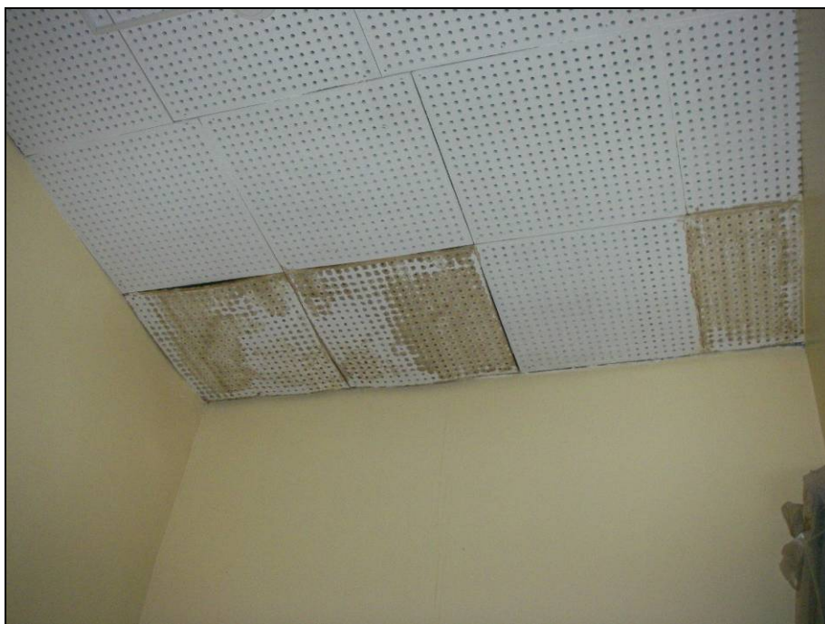
Рисунок 7 - Намокание конструкций перекрытия и подвесного потолка на 1-м этаже под санузлами
