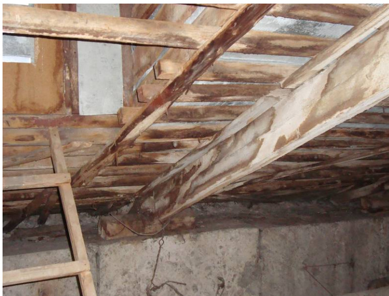
Рисунок 38 - Отмечено гниение древесины из-за старых протечек кровли, продольные трещины от усушки.
