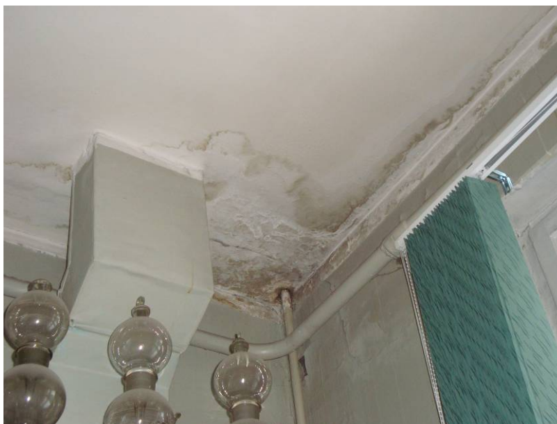
Рисунок 37 - Намокание бетона плит и коррозия арматуры в месте пропуска труб инженерных коммуникаций.
