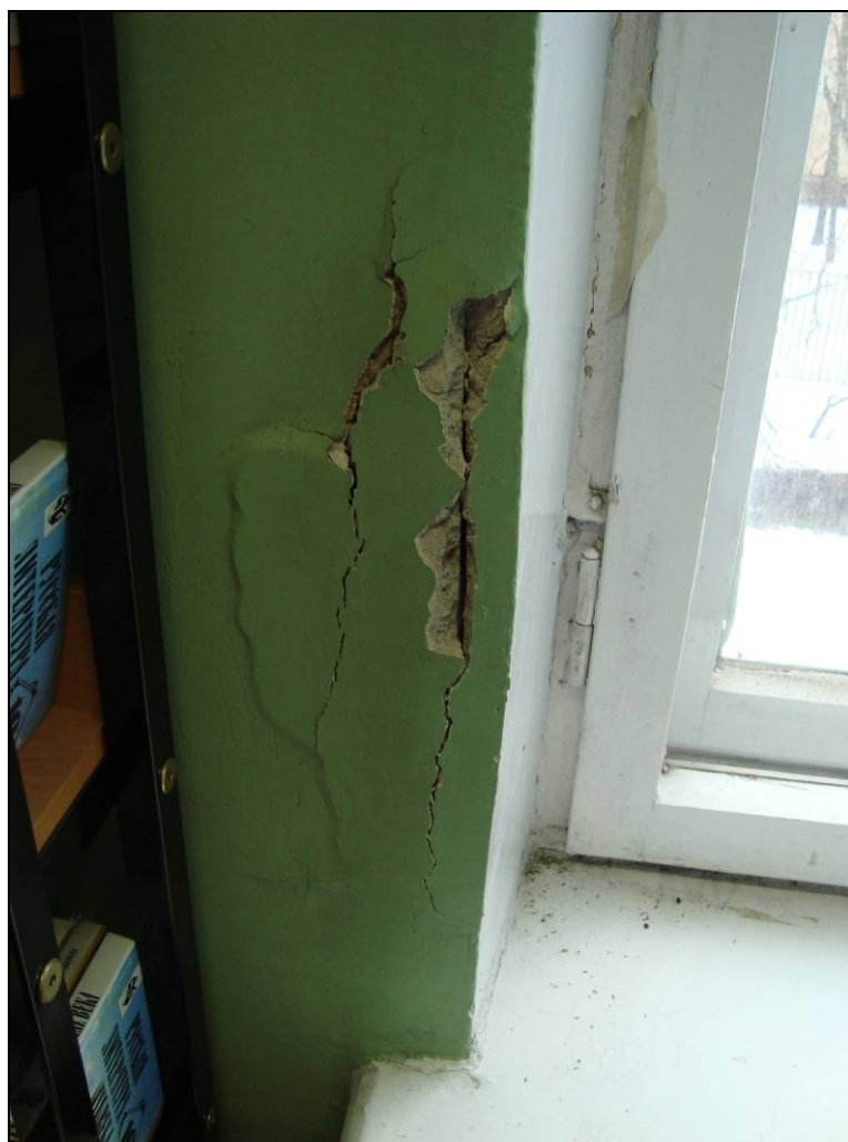
Рисунок 16 - Отслоение защитного слоя бетона блока вдоль корродирующей арматуры у оконного проема второго этажа в стене по оси 1/А-В.
