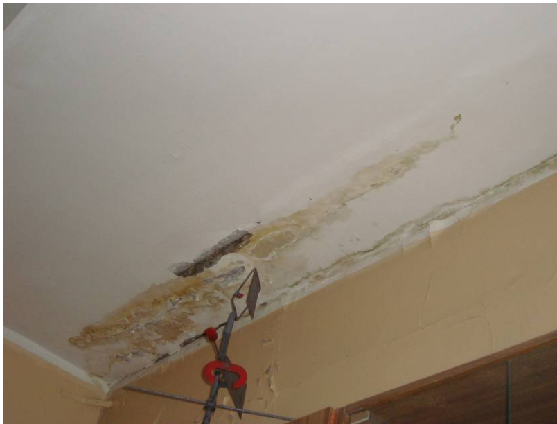
Рисунок 36 - Намокание бетона плит и коррозия арматуры из-за протечек кровли (5 этаж, оси 11/Ж).
