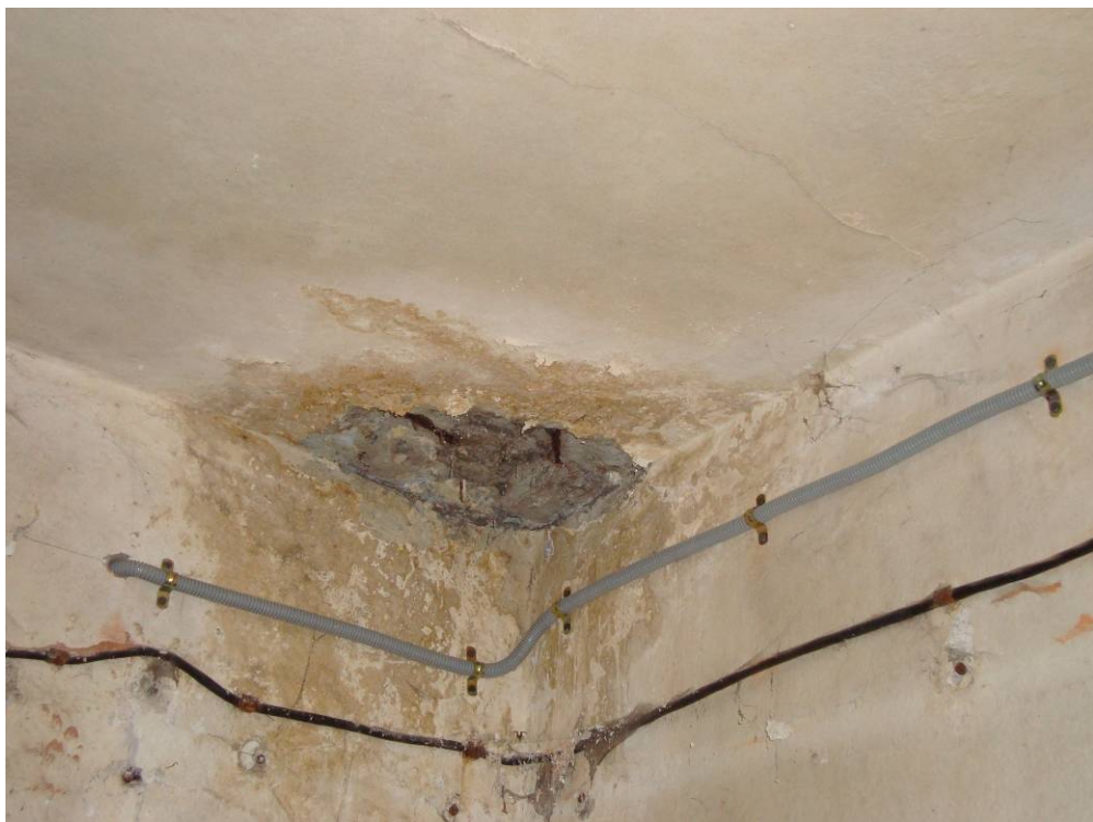
Рисунок 18 - Разрушение защитного слоя бетона, коррозия арматуры на участке пропуска труб инженерных коммуникаций в подвале (оси 10-11/Г-Ж).
