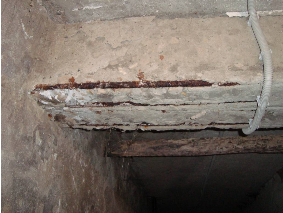
Рисунок 17 – Коррозия бетона и арматуры балок коммуникационного коридора в осях Д-Е/3-10 в местах сопряжения перекрытия с наружной стеной из-за протечек.
