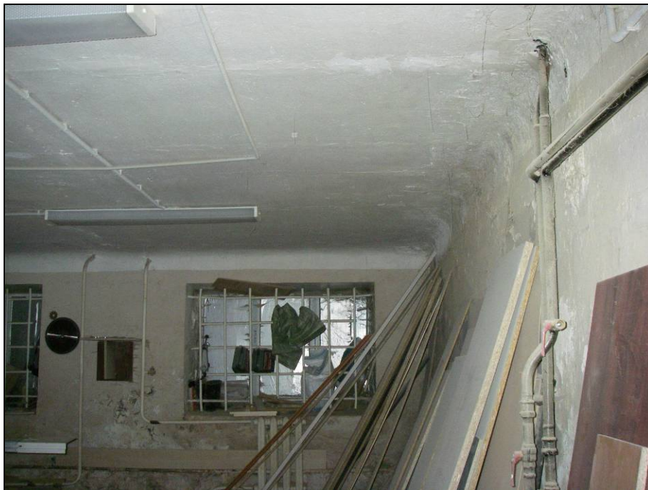
Рисунок 2 - Отслоение штукатурного слоя стен подвала из-за неудовлетворительного состояния отмостки и вертикальной гидроизоляции стен.
