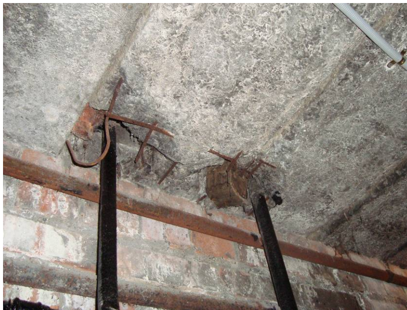
Рисунок 34 – Выполнены отверстия для пропуска коммуникаций в плитах перекрытия подвала. Отмечено разрушение бетона и коррозия арматуры (рабочие арматурные стержни не повреждены).
