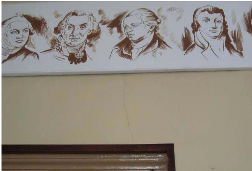
Рисунок 32 - Трещина в перемычке дверного проема по силикатобетонному блоку внутренней стены из-за общих деформаций здания (4 этаж).
