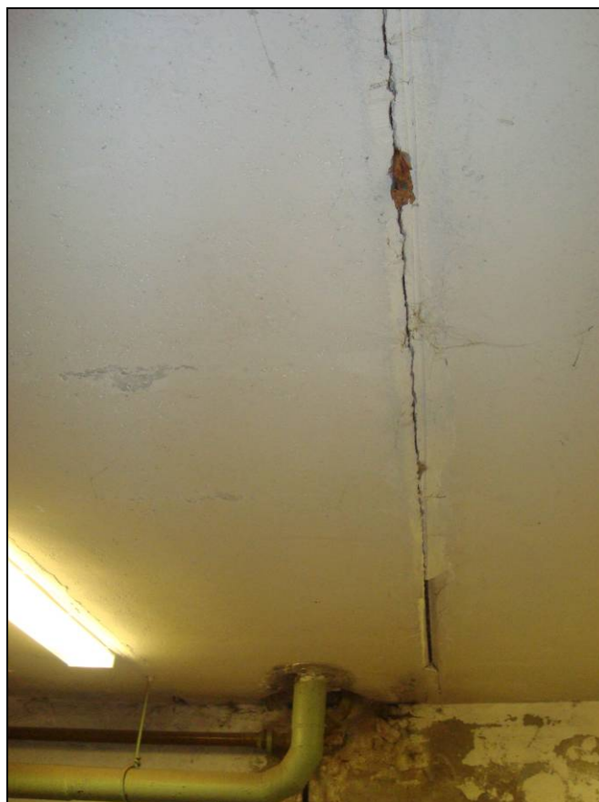
Рисунок 27 - Трещина по швам и повреждение шва заделки между плитами в осях 4/Г-Е. В местах пропуска труб коммуникаций отмечены протечки.
