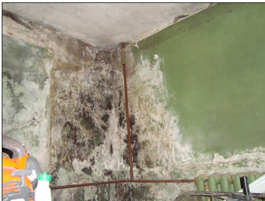
Рисунок 13 - Отслоение штукатурного слоя стен подвала по оси 12/Ж, развитие плесени из-за неудовлетворительного состояния отмостки и вертикальной гидроизоляции стен.
