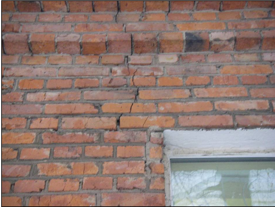
Рисунок 1 - Трещина над оконным проемом из-за неравномерных осадок фундаментов
