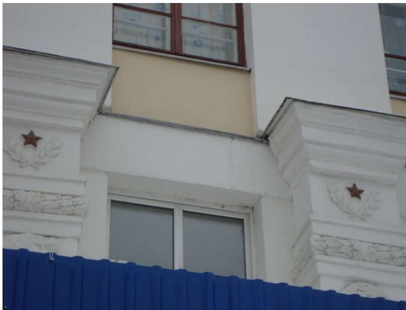
Рисунок 31 - Трещина по керамзитобетонному блоку-перемычке в уровне 2-го этажа шириной раскрытия \delta_{\text{тр}}=0,5 мм.
