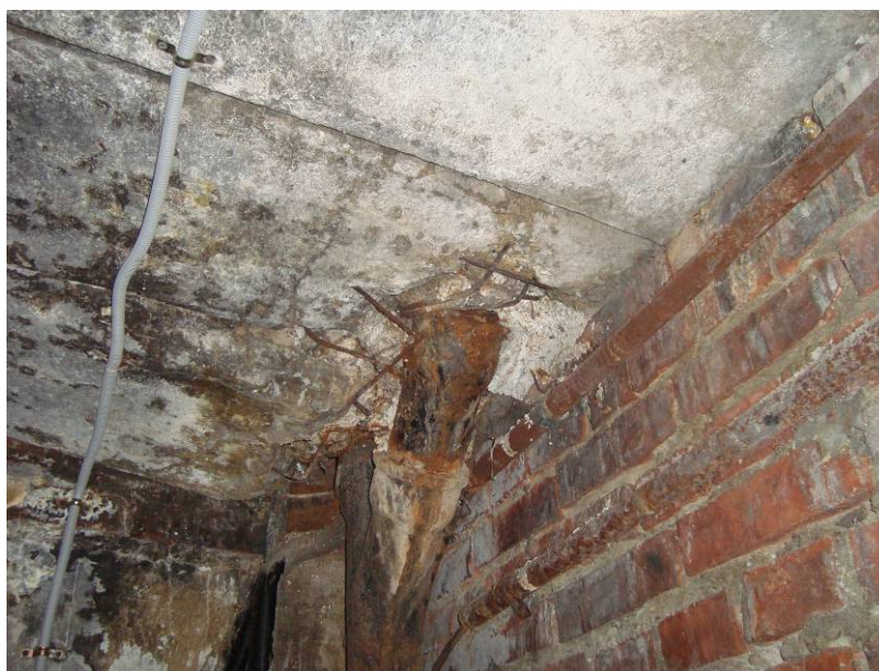
Рисунок 35 - Выполнены отверстия для пропуска коммуникаций в плитах ( b=0,4\text{м} ) перекрытия подвала в осях 3-10/Д-Е. Отмечено разрушение бетона, повреждение арматурных стержней и коррозия арматуры. Требуется усиление или замена.
