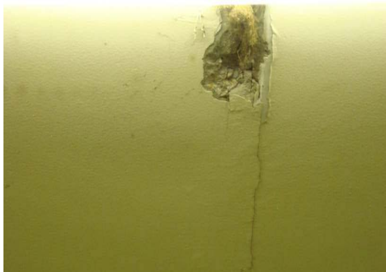
Рисунок 15 - Скол защитного слоя на первом этаже, трещины по швам.
