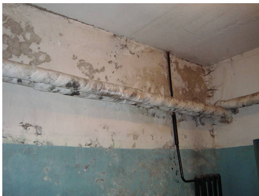
Рисунок 14 - Отслоение штукатурного слоя стен подвала из-за неудовлетворительного состояния отмостки и вертикальной гидроизоляции стен.
