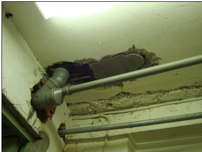
Рисунок 26 - Пробито отверстие в пустотной плите перекрытия подвала для пропуска труб коммуникаций. Повреждена анкеровка крайнего арматурного стержня (разрушен бетон плиты на опоре). Повреждена кирпичная кладка перегородки над дверным проемом.
