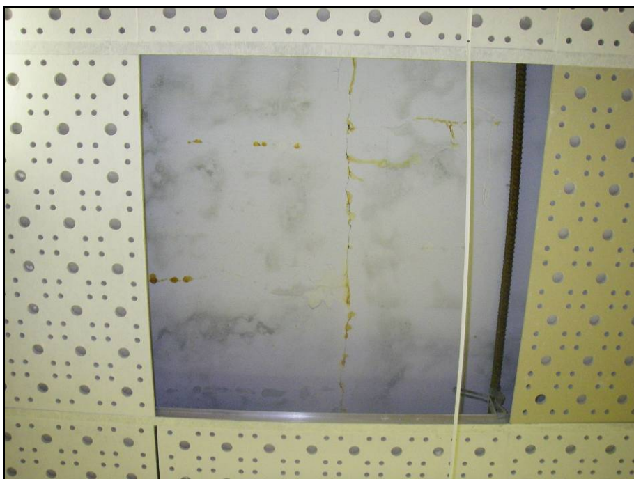
Рисунок 8 - Трещина по штукатурному слою перекрытия, а также намокание плит перекрытия третьего этажа
