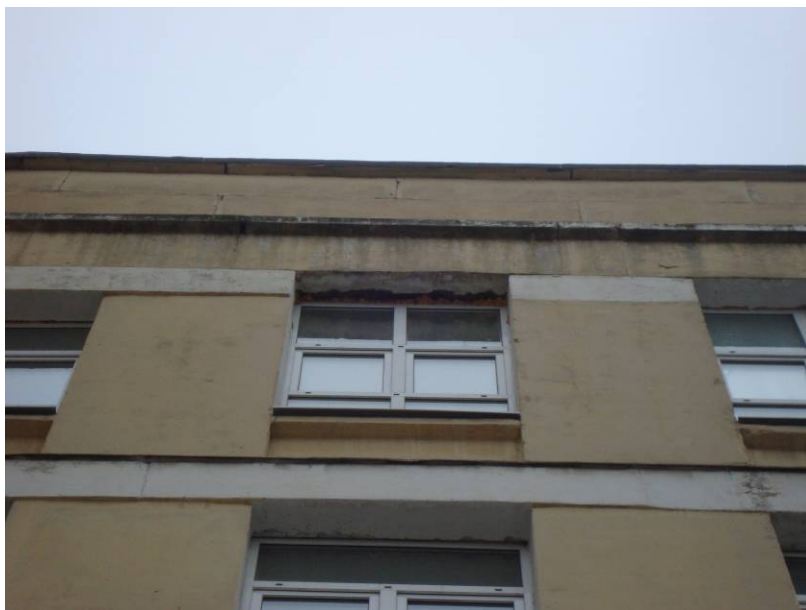
Рисунок 23 - Разрушение штукатурного слоя в проеме окна
