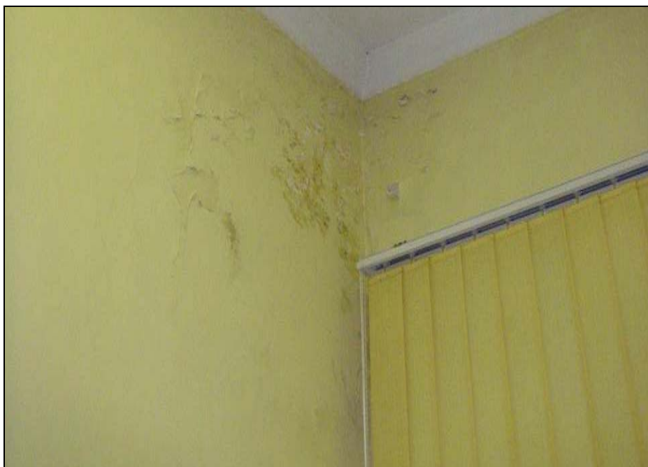
Рисунок 3 - Намокание штукатурного слоя стен под санузлами.
