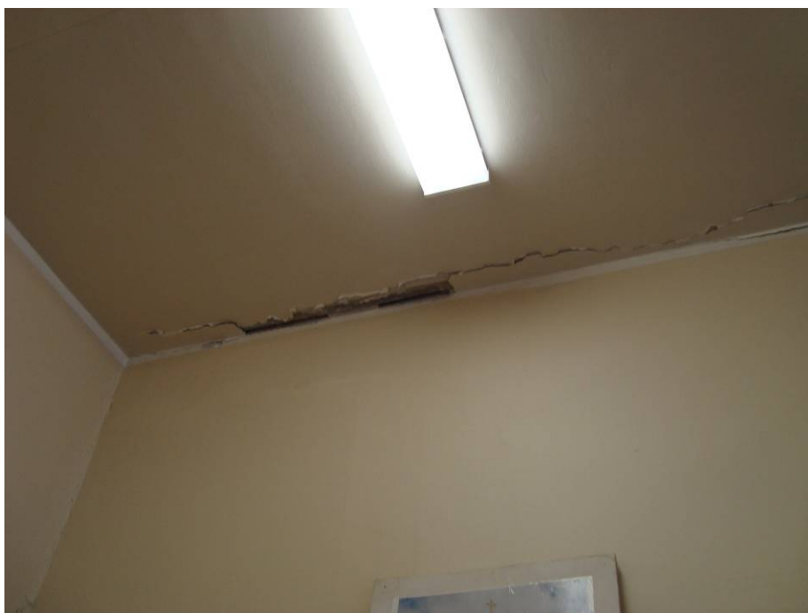
Рисунок 20 - Трещина по штукатурному слою перекрытия, выпадение раствора из швов
