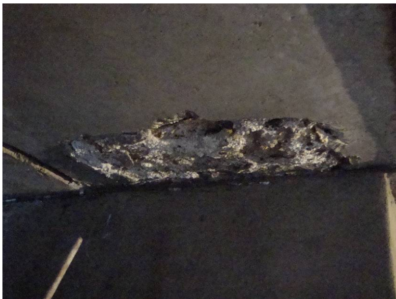
Рисунок 29 - Разрушение бетона пустотной плиты покрытия в месте пропуска на кровлю воздухопроводов размером 2х2 м. с опиранием на плиты перекрытия 5-го этажа. В швах плит перекрытия 5-го этажа отмечены трещины из-за разности прогибов плит при повышенной нагрузке от воздухопроводов.
