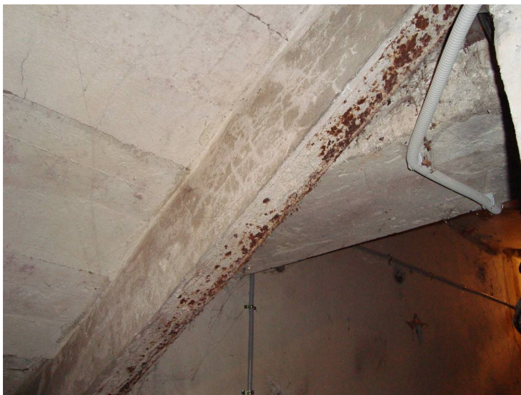
Рисунок 22 – Косоур лестницы, затронутый коррозией.
