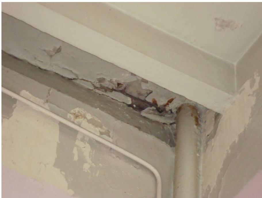
Рисунок 19 - Коррозия бетона и арматуры монолитного участка из-за протечек кровли (оси Е/10).
