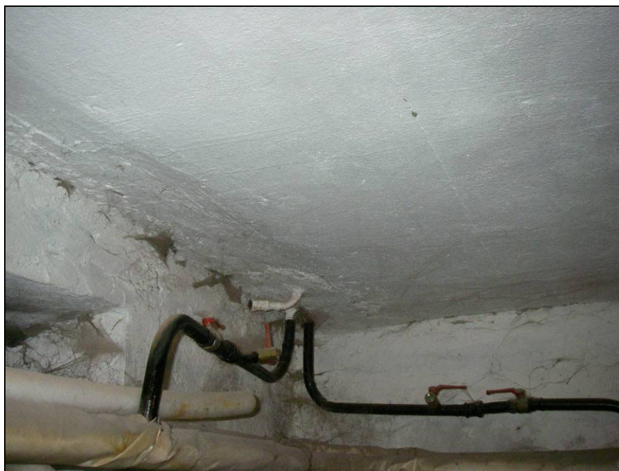
Рисунок 5 - Трещина по межплитному шву. На участке пропуска коммуникаций отмечено намокание штукатурного слоя плит шириной 0,4 м.
