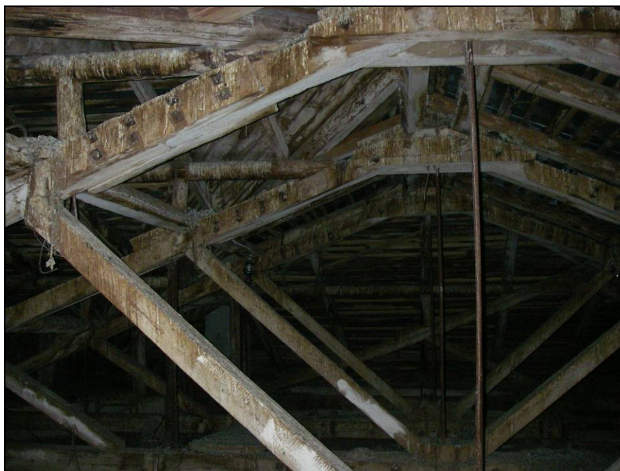
Рисунок 9 - Общий вид покрытия в центральной части здания. Отмечено значительное намокание стропильной системы из-за постоянных протечек с кровли.
