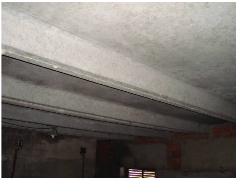
Рисунок 30 - Прогиб ребристой плиты покрытия в осях 3/А-В по отношению к другим плитам на 20 мм.
